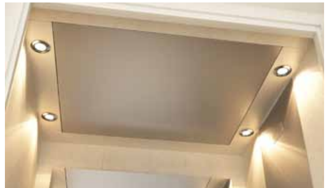
Techo de la cabina con cuatro focos
